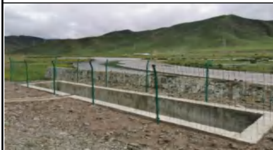
K16+970 事故应急池
