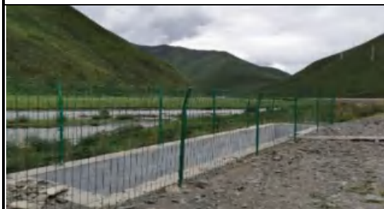
K131+880 事故应急池
