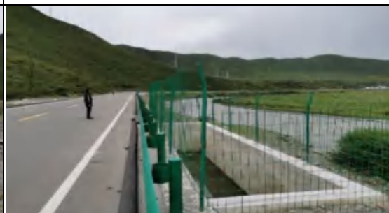
K132+420 事故应急池
