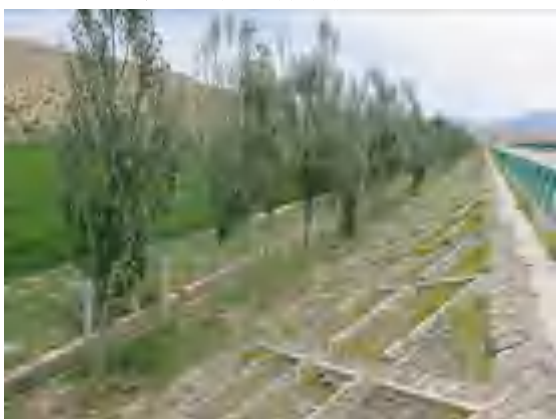
路基边坡菱形骨架护坡
