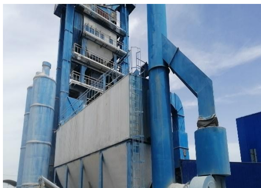
沥青拌合站配套除尘器
